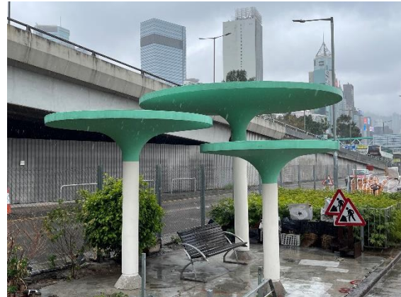
Abb. 1: Beton-Pavillons in Causeway Bay vor der Renovierung
